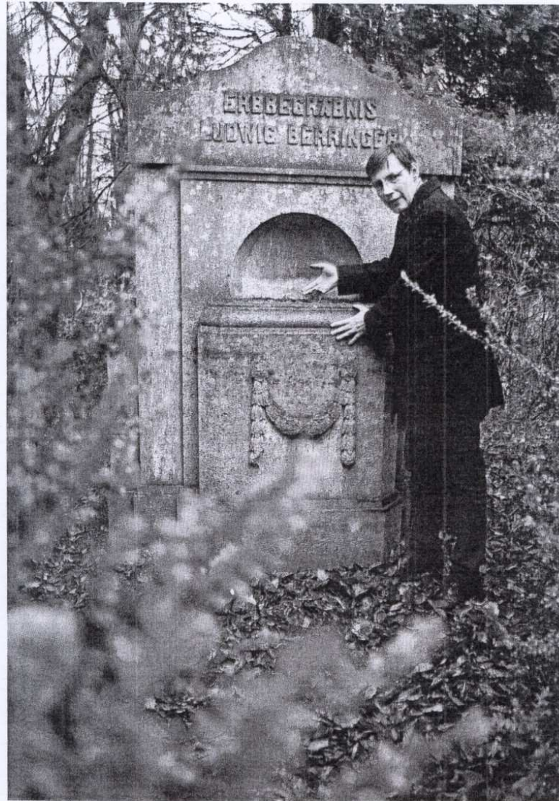
Vereinsvorsitzender Hannes Rother am Grabmal des Bäckermeisters Ludwig Berringer: Fugensanierung, Frostschutz und Standsicherheit.
